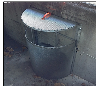
El dispositivo de captura de basura completo cubre la abertura de la tubería para bloquear la basura y dejar pasar el agua.
